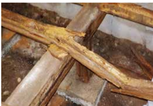
▲床下のツカ(写真:上)や大引き(写真:下)が蟻害でボロボロ
