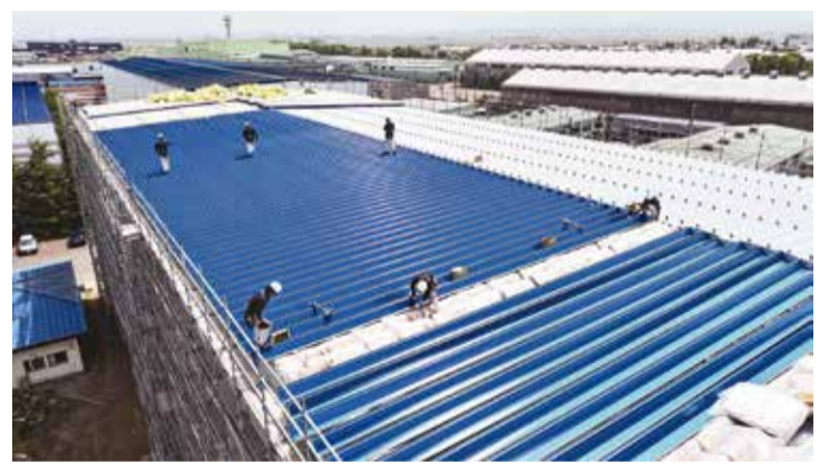
高さ・大きさ共に今期一番の大規模工事となりました▲(ドローンで撮影)
